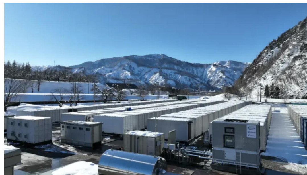
コンテナ型データセンター「湯沢GXデータセンター」(湯沢町)
